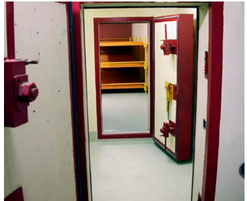
Secteur de protection avec portes blindées
